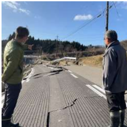
国道359号の道路陥没(内山地区)を調査する坂本ひろし(党県書記長)と砂田前市議 11月6日
