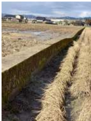
沈下し歪んだ畦=正得地区
