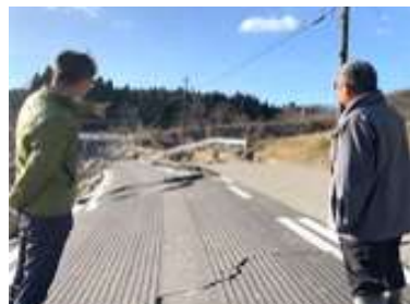
国道359号の道路陥没現場で坂本ひろし党県書記長(左)=5日
